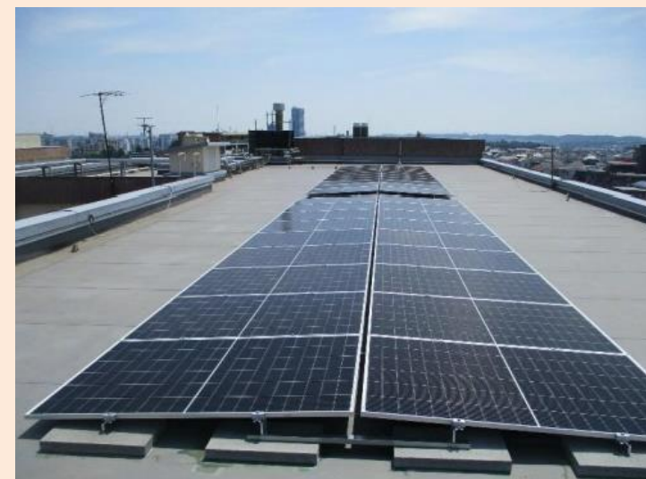
PPA事業により設置された太陽光パネル
