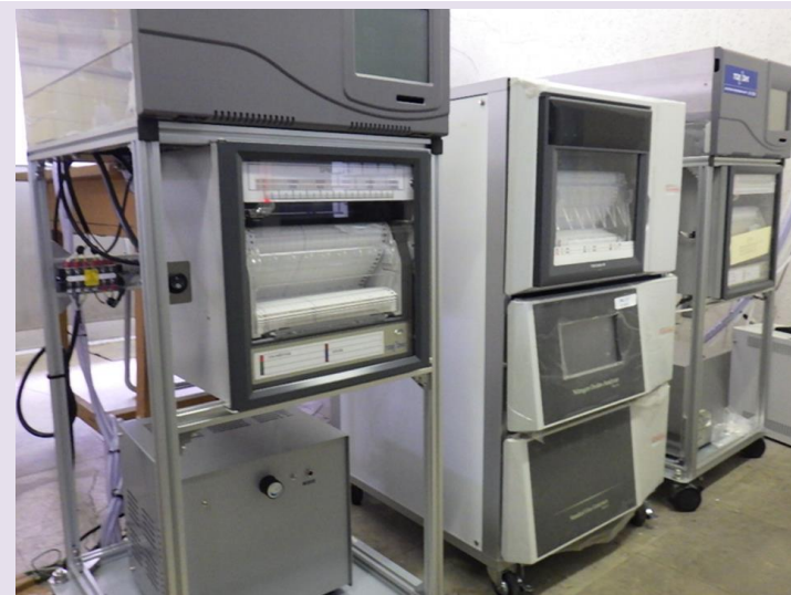
大気汚染測定室
