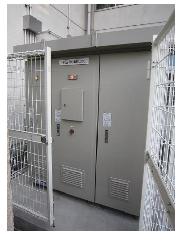
城山中学校の蓄電池 (過去の工事例)
