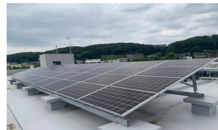
石川市民センターに設置した 太陽光パネル
