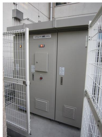
城山中学校の蓄電池 (過去の工事例)
