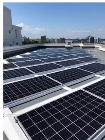
台町市民センターに設置した 太陽光パネル
