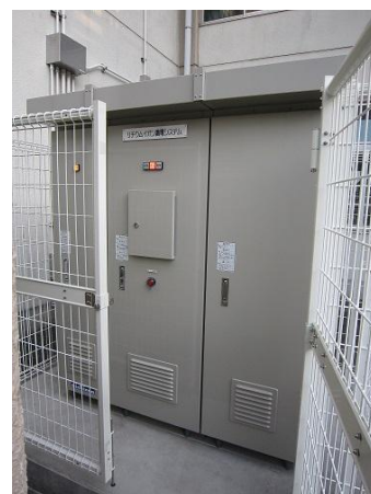
城山中学校の蓄電池
