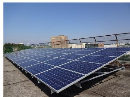
柏木小学校の太陽光パネル
