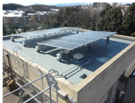
宮上中学校の太陽光パネル
