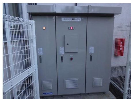
陵南中学校の蓄電池
