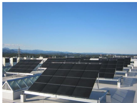
エスフォルタアリーナ八王子の太陽光パネル
