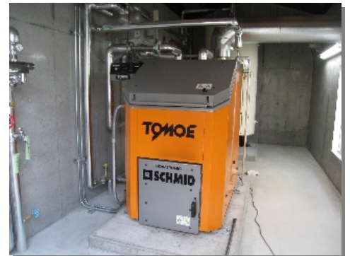
北野清掃工場の木質バイオマスボイラー
