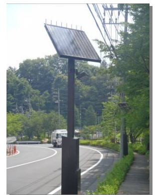
戸吹クリーンセンターの街路灯
