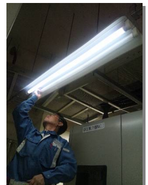
あったかホールのＬＥＤ蛍光灯
