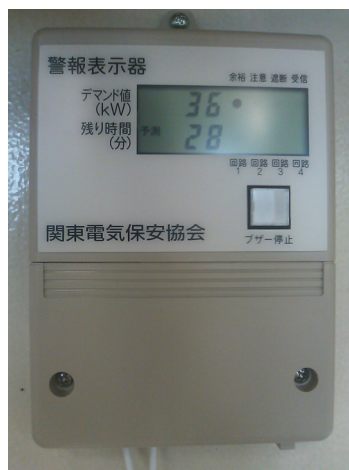
デマンド監視装置
