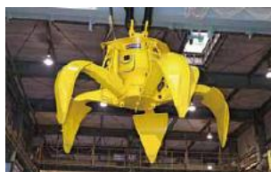
ごみクレーン
