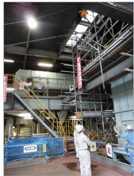
右、バグフィルター 中上、No.2 搬送コンベヤ
