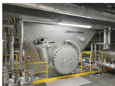
流動床炉式ガス化燃焼炉
