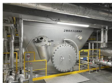
流動床炉式ガス化燃焼炉
