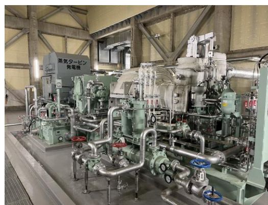
蒸気タービン発電機 最大出力 4,440 kW
