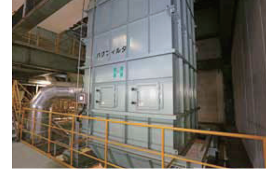
バグフィルタ 建物内の空気は、バグフィルタを通して、粉じんを除去してから大気へ放出します。
