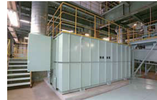
脱臭装置 処理工程で発生する臭気を清浄化し、大気へ放出します。
