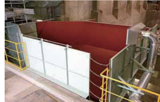
受入ホッパ・供給コンベヤ 投入された不燃ごみを不燃ごみ破砕機に送ります。
