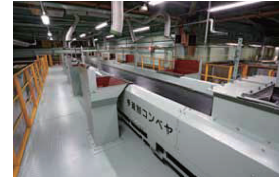
手選別コンベヤ 選別された不燃ごみの中から有価物である金属、小型家電等を手選別します。
