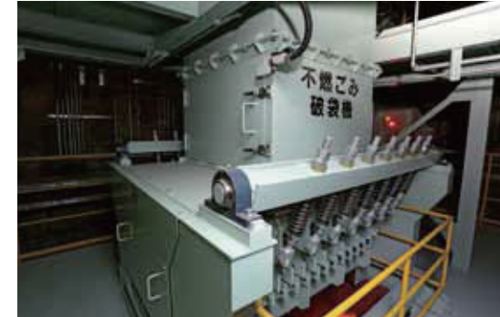
不燃ごみ破砕機 袋状の不燃ごみを、回転する刃と固定された刃で破き、袋と内容物を分離します。
