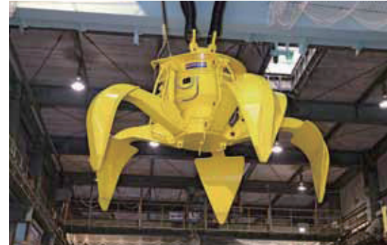
ごみクレーン ピットに貯められたごみはごみクレーンにて受入ホッパへ投入します。
