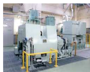
蒸気タービン発電機
