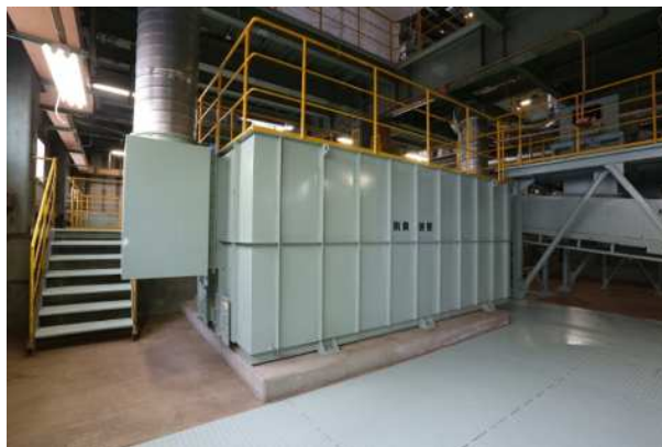
②脱臭装置
