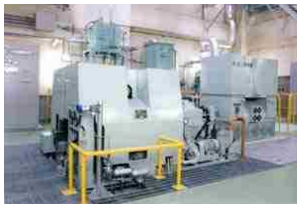
蒸気タービン発電機
