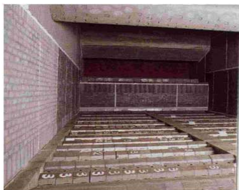
焼却炉の内部
