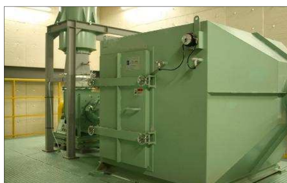
③活性炭吸着式脱臭装置
