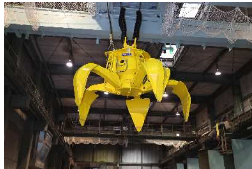
ごみクレーン
