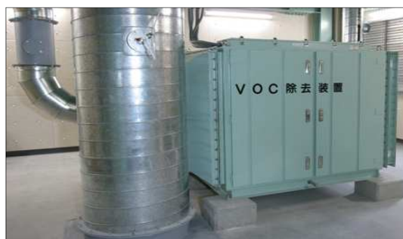
②VOC除去装置
