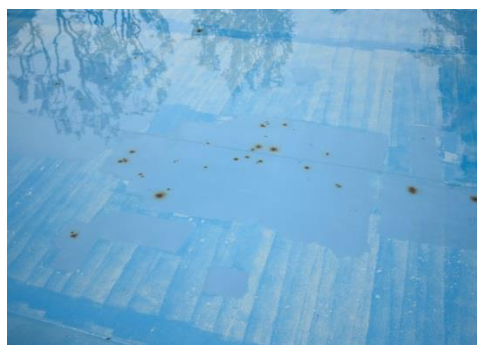
幼児プールの底の錆
