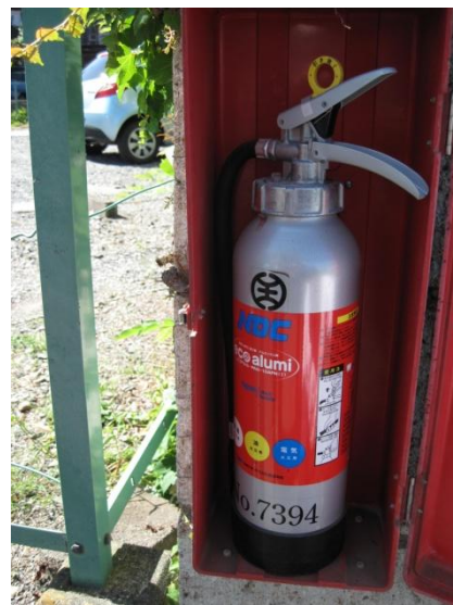
《街頭消火器の本体》
