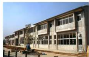
16.建設中のみなみ野小中学校. jpg
