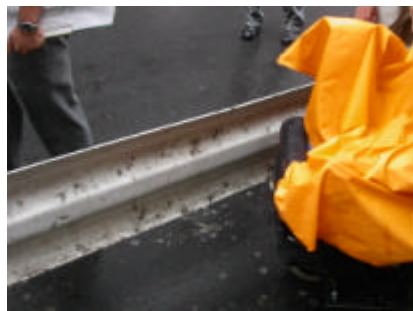
富士見通り ガードレールが旧タイプのもので、接触した時に危険である
