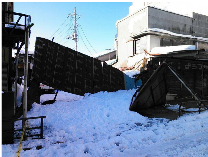
▲アーケード落下状況(八幡町)
