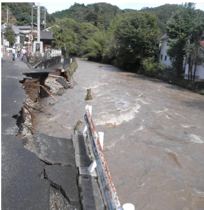
▲南浅川護岸崩落状況（西浅川町） （平成29年台風第21号）
