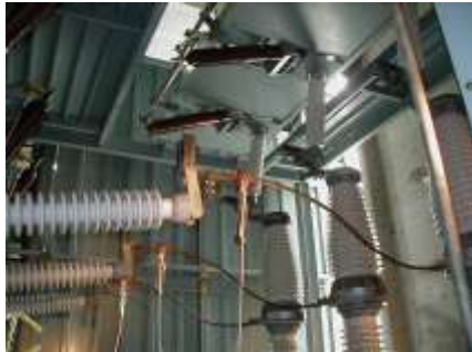
(66,000V 特別高圧受電設備)
