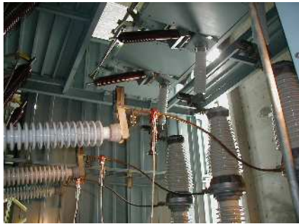
( 66,000V 特別高圧受電設備 )
