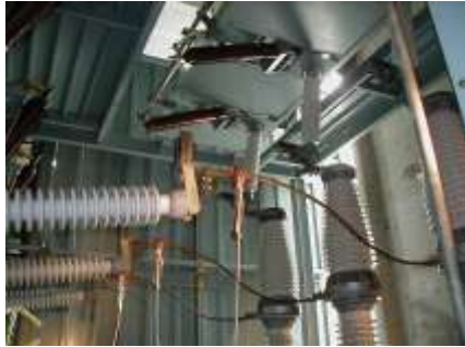
(66,000V 特別高圧受電設備)
