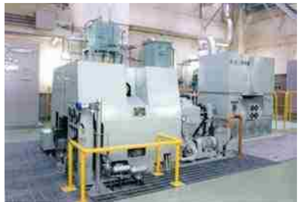
蒸気タービン発電機
