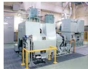
蒸気タービン発電機
