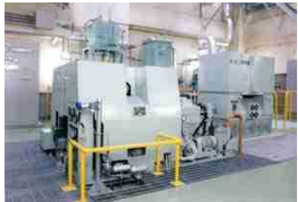
蒸気タービン発電機
