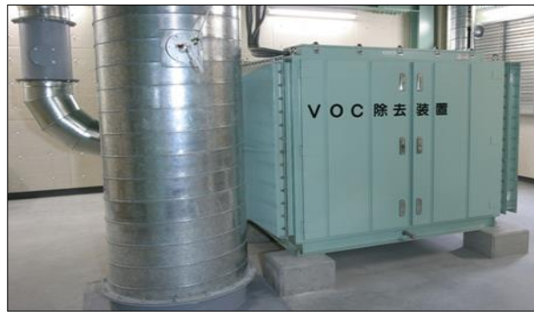
②VOC除去装置
