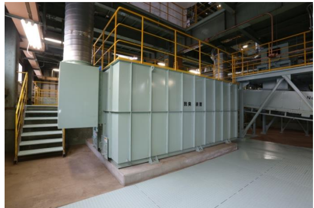
②脱臭装置
