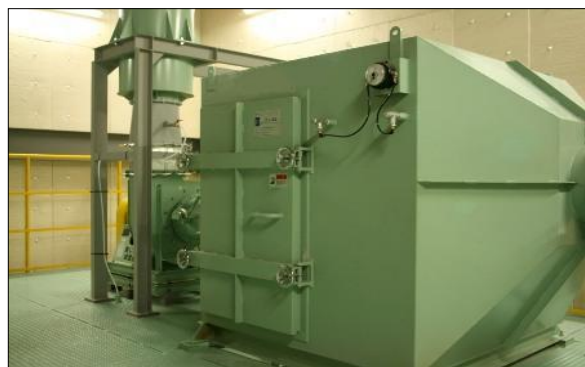
③活性炭吸着式脱臭装置
