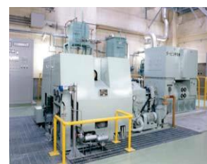
蒸気タービン発電機
