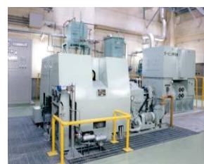
蒸気タービン発電機
