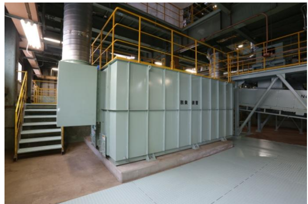
② 脱臭装置
