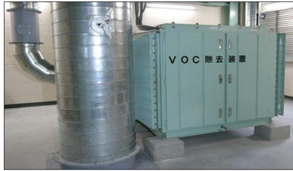
②VOC除去装置
