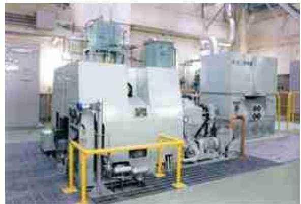
蒸気タービン発電機
