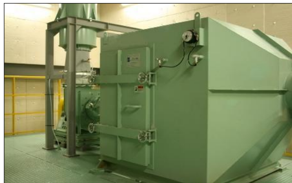
③活性炭吸着式脱臭装置
