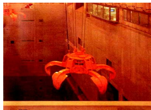
ごみクレーン
