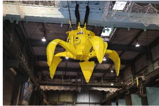
ごみクレーン
