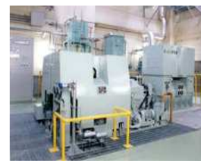
蒸気タービン発電機
