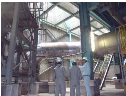
焼却設備日常点検
