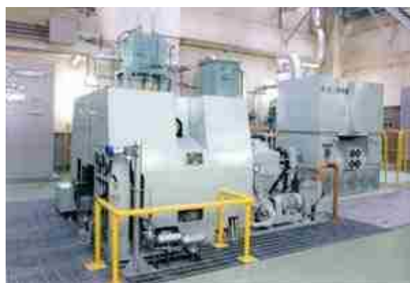
蒸気タービン発電機
