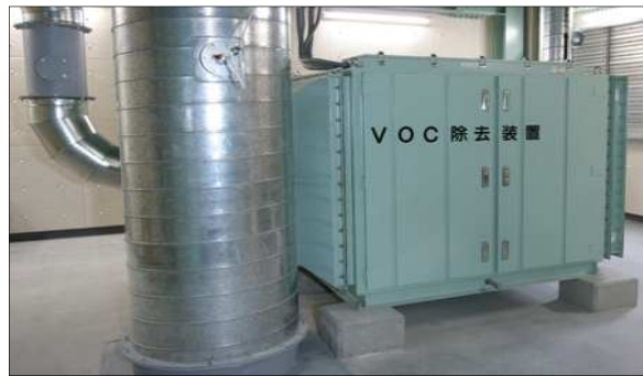
VOC除去装置
