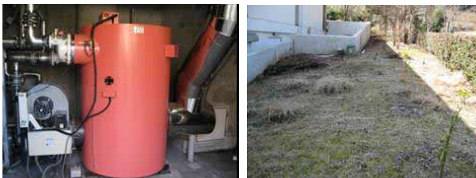
図表 1-78 施設写真(ボイラと施設脇のスペース)
