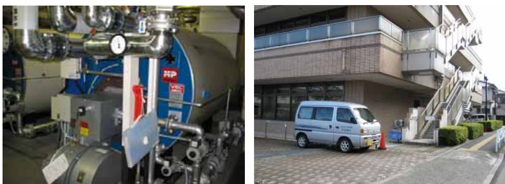
図表 1-74 施設写真 (ボイラと施設外観)
