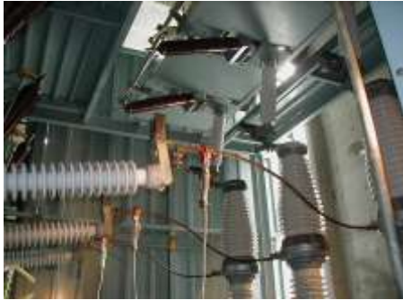
(66,000V 特別高圧受電設備)
