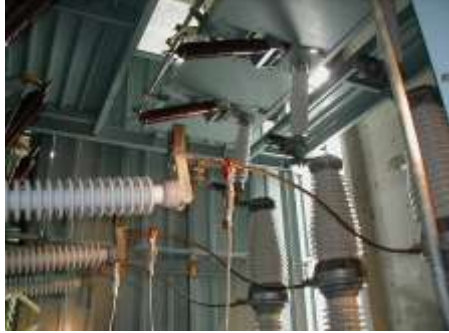
(66,000V 特別高圧受電設備)
