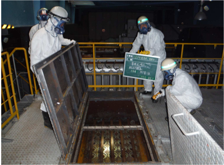
・ 焼却炉内部
