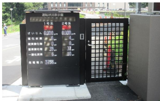
運転状況表示盤
