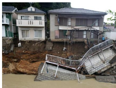
令和元年東日本台風 廿里町南浅川の護岸崩壊状況
