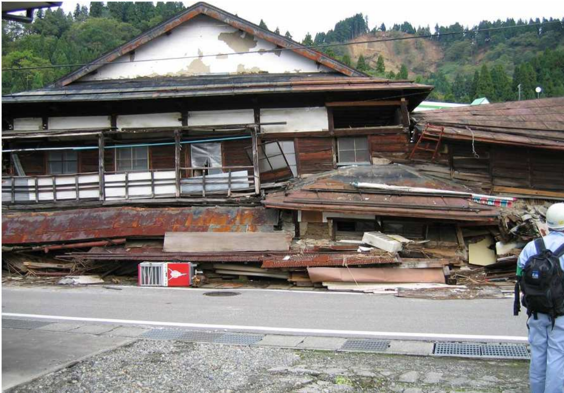
붕괴한 목조주택(한신·아와지 대지진으로 인하여) 倒壊した木造住宅(阪神・淡路大地震で)
