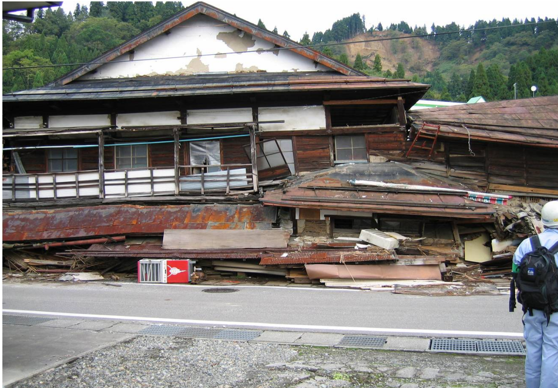
▲ Collapsed Wooden Houses (Han-Shin Awaji Earthquake Disaster) ▲ 倒壊した木造住宅（阪神・淡路大地震で）
