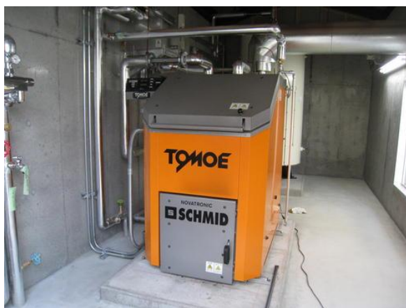
北野清掃工場内に設置されている 木質バイオマスボイラー
