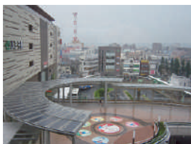
八王子駅南口の とちの木デッキ の太陽光発電装置 (平成 22 年度設置・12.8kW)
