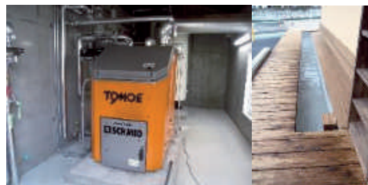
木質バイオマスボイラと啓発用足湯
