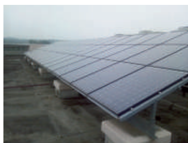
七国中学校の太陽光発電装置 (平成 15 年度設置、10kW)
