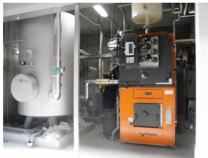
チップボイラと蓄熱タンク
