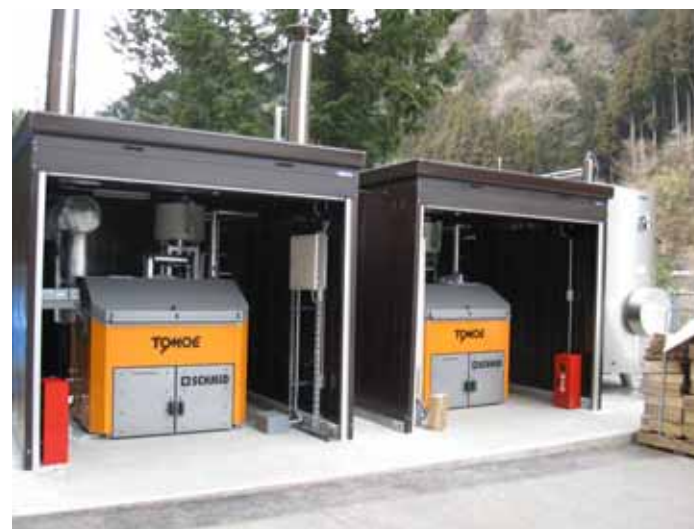
ボイラ室と薪ボイラ
