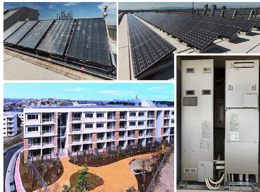
東京ガスの「磯子スマートハウス」に導入されたエネルギー供給源
