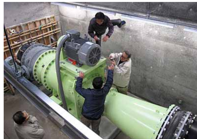
橿原中学校のチューブラ水車 (小水力発電データベースより)
