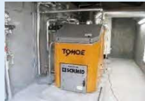
足湯のお湯を作る薪ボイラー
