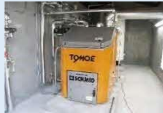
足湯のお湯を作る薪ボイラー
