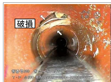
下水道老朽管の破損
