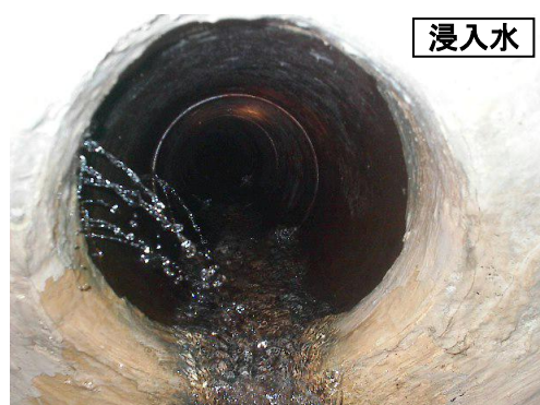
下水道管の老朽化の状況 (老朽化が進み地下水が浸入してしまっている)
