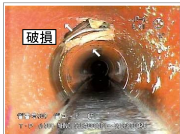
下水道老朽管の破損
