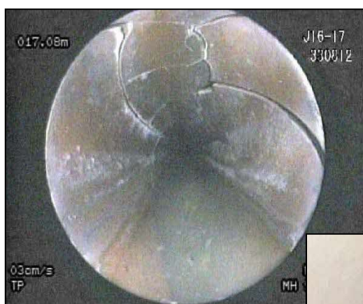
← [破損した管路]
