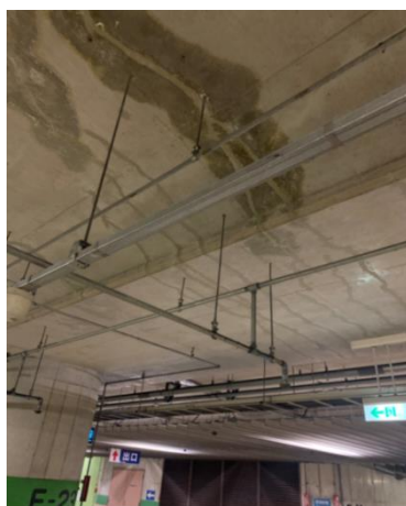
天井からの漏水
