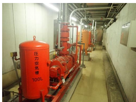
泡消火設備 (火災時に泡で消化)
