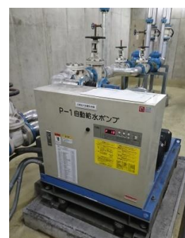
給水ポンプ (トイレ等に給水)
