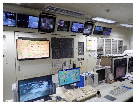
ITV モニター (設備状態や利用者の安全を監視)
