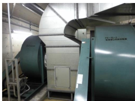
排気機械設備 (自動車の排気ガスを地上へ排出)
