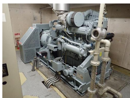
自家用発電機設備 (非常時に電力を供給)
