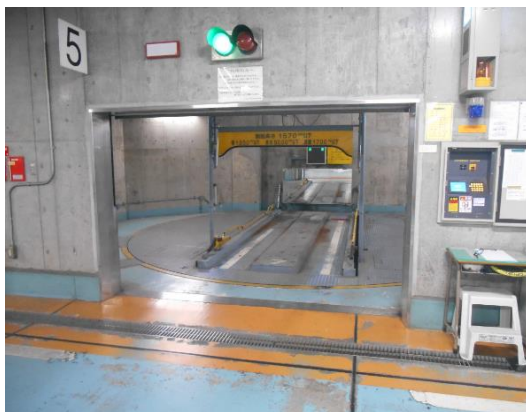
写真 2.3 機械式駐車場設備
