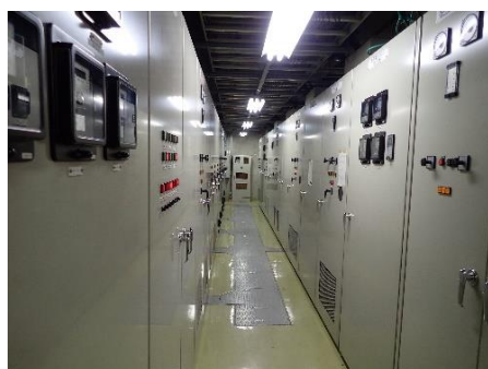
高圧受変電盤 (マルベリーブリッジや地下自由通路、自転車駐車場にも配電)
