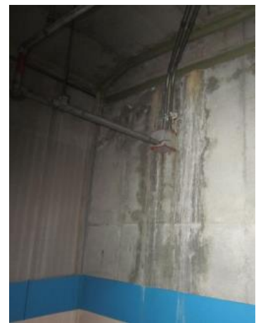
壁面からの漏水
