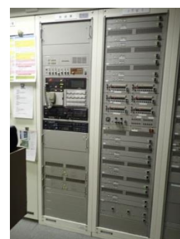
非常用放送設備 (非常放送や、平常時は閉場案内等を放送)
