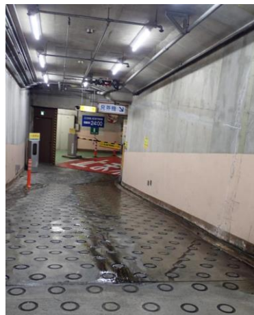
床面からの漏水
