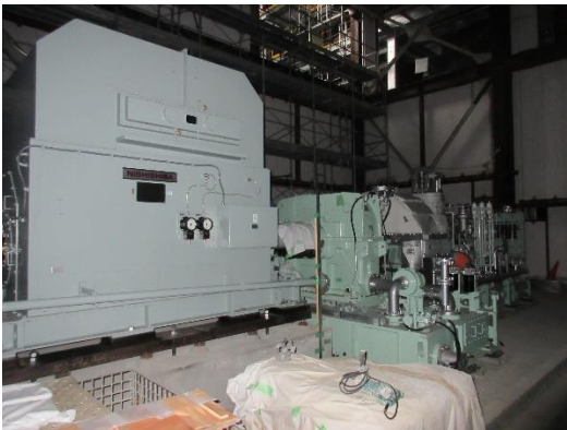
発電機室の様子
