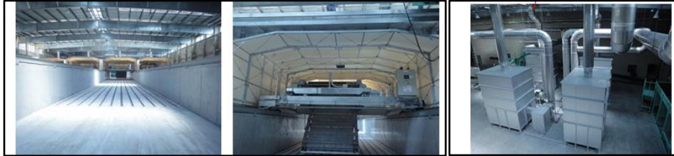
図 I-2-8 当初の脱臭設備
