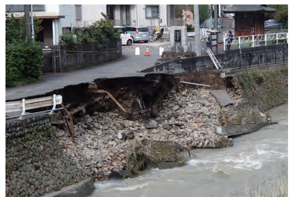
南浅川護岸崩落（H29.10.23）
